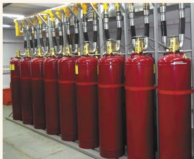
Автоматические системы газового пожаротушения (АГПТ) производства ГК «Пожтехника» с применением газового огнетушащего вещества 3M™Novect™1230 (ФК-5-1-12)
